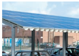
5-boxige Solar-Carportanlage - 14,80 kWp
